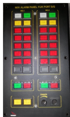
报警板 Alarm panel
